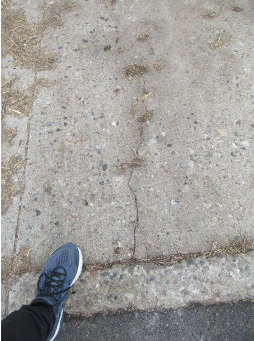
Slæbested øst - Belægning Revne i belægning.
