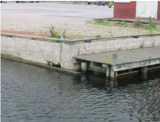
Kajstrækning øst - Kajvæg Afskaldning og grov revne i vestlig ende.
