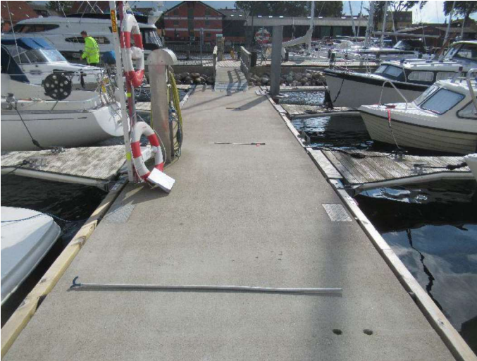
Bro 3 - Brodæk Oversigt af tværgående revner
