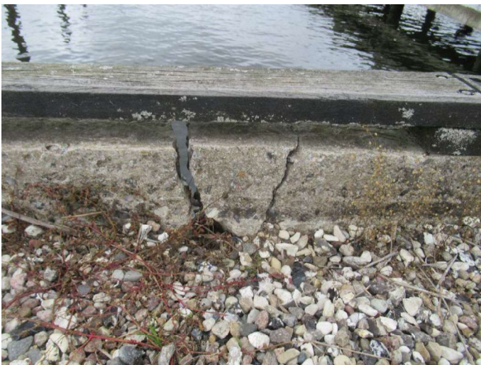
Kajstrækning øst - Kajvæg Grove gennemgående revner i væggen
