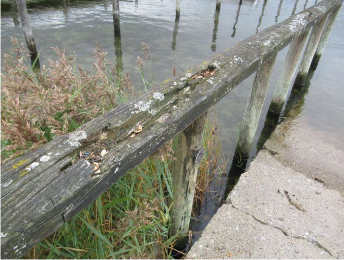
Slæbested øst - Rækværk Kraftigt råd og nedbrydning i bjælke/håndliste.
