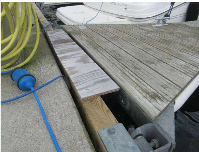
Bro 3 - Pontonarme Midlertidig inddækning af afstand imellem pontonarme og flydebro. Afstanden er ca. 13cm.
