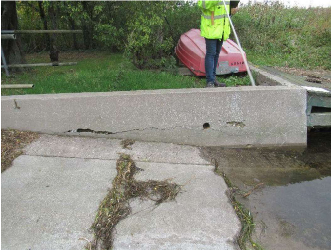
Slæbested vest - vægge Grove revner og afskaldninger i væggen.
