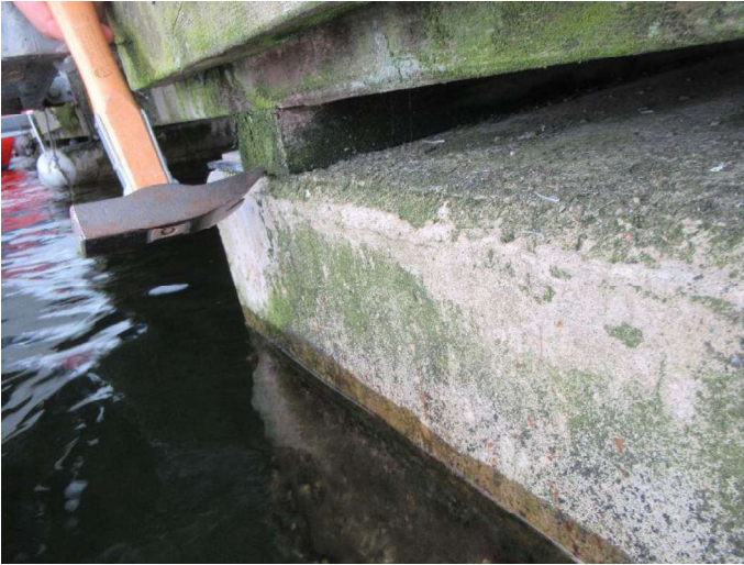
Bro 1 - Bjælker Algebelægning samt begyndende nedbrydning i bjælker
