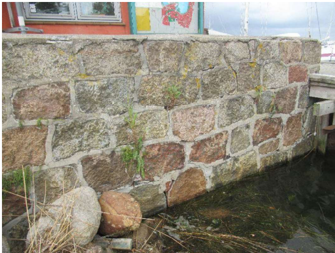
Stenkastning øst - Kajvæg Revner og mindre afskaldninger i mørtel.
