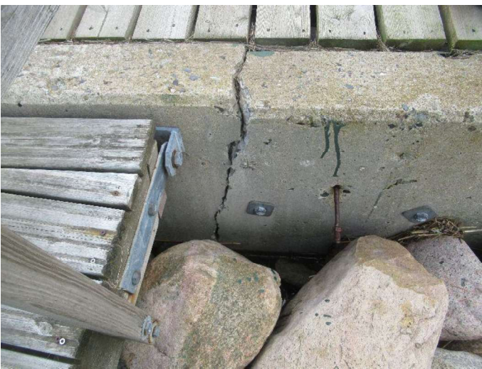
Bro 4 - Revner i støttemur
