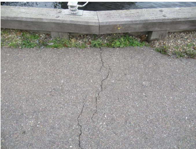
Kajstrækning syd indre Revne i asfalt bag kajvæg. Kan antyde at der er sætninger bag væggen - evt. pga. udskyldning af materiale.
