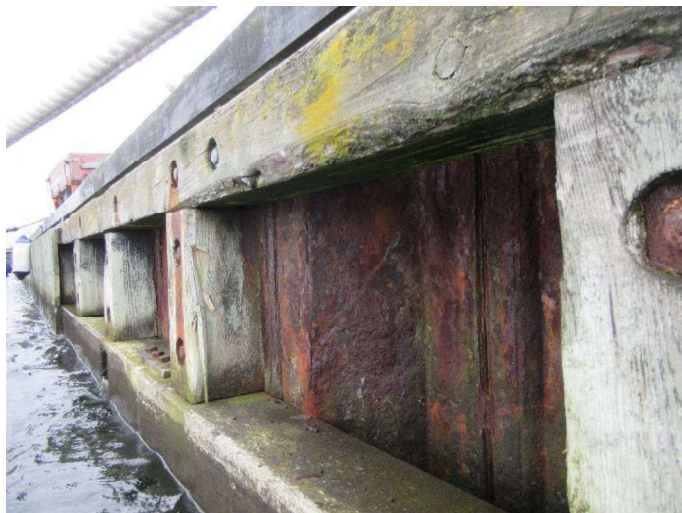
Kajstrækning øst indre - Kajvæg (stål) Tilstand med kraftig overfladekorrosion på stålpunsen.
