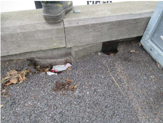
Kajstrækning vest ydre - kajvæg Gennemgående ses der lunke i overfladen ved stolperne langs hele kajstrækning fra stenkastning vest til kajen slår et knæk mod nord.
