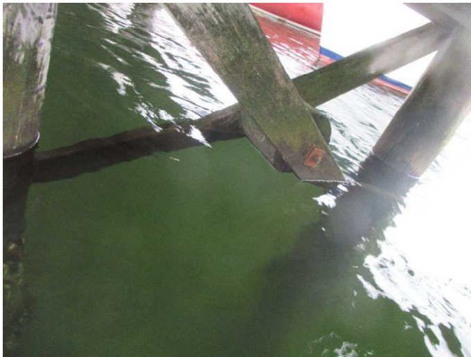
Bro 2 - Afstivning Rust i boltesamling og algebelagte lægter.
