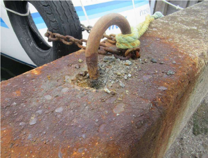
Kajstrækning øst indre - Fortøjningsudstyr Kraftig gennemtæring af forankringsudstyr i betonkajen.
