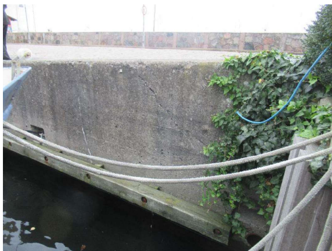
Kajstrækning øst indre - Kajvæg (beton) Skrå revne i starten af kajen (ved kaj syd indre).
