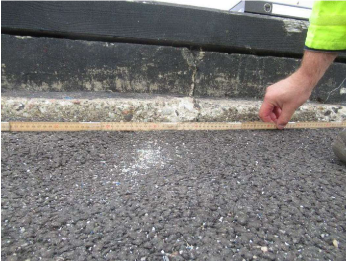
Kajstrækning vest indre - Kajvæg Lunker i asfalt med kajvæggen på den anden side.
