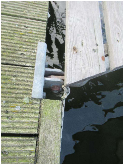
Bro 1 - Y-bomme Begyndende korrosion ses i bolte i boltesamlinger.
