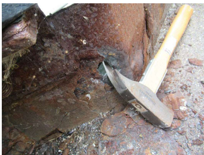
Kajstrækning øst indre - Kajvæg (stål) Helt gennemtæret stålvæg ved overfladen.
