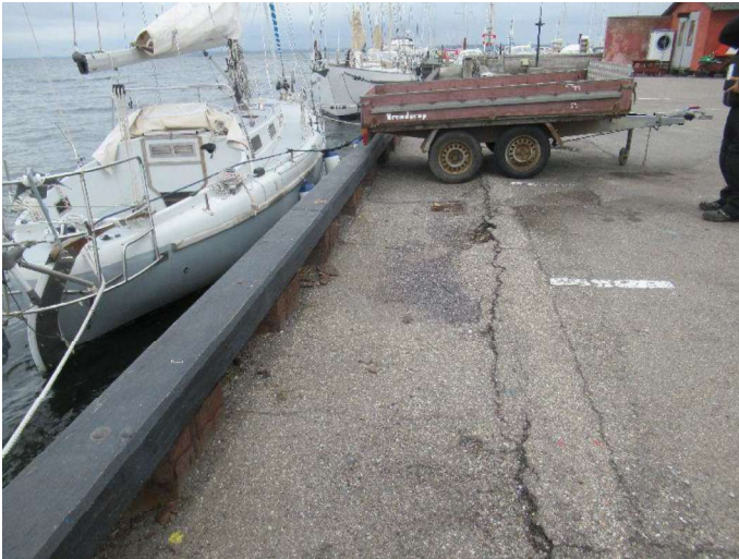
Kajstrækning øst indre - Belægning Belægning mod spuns i nord-vestlig hjørne.
