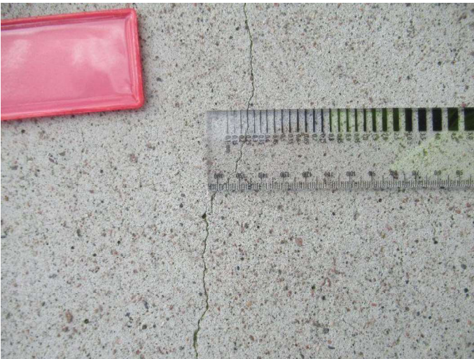
Bro 3 - Brodæk Nærbillede af tværgående revne.
