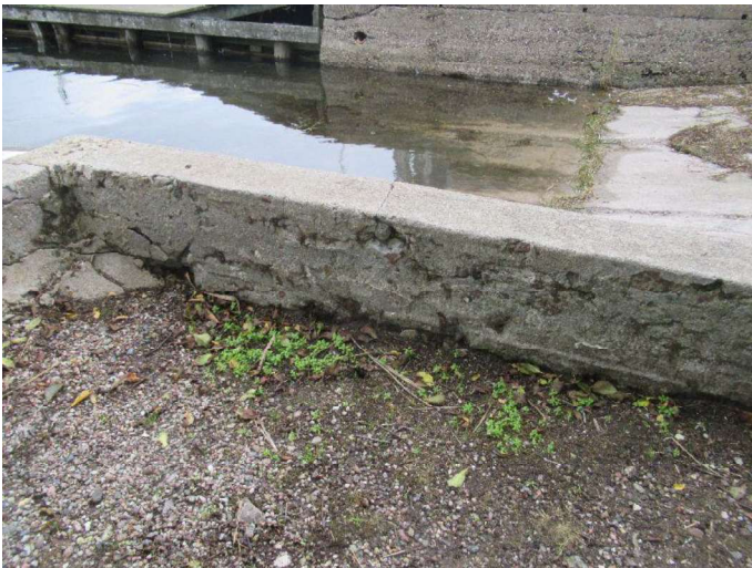
Slæbested vest - vægge Grove revner på væggenes bagside samt adskillige kalkspringere.
