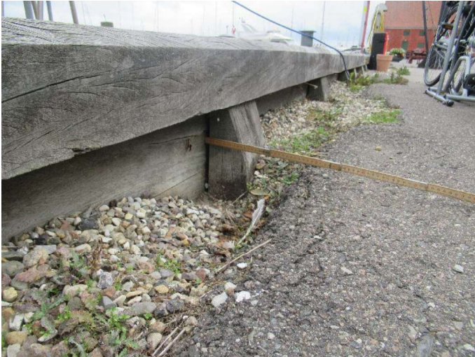
Kajstrækning syd indre - Kajvæg Lunker i overfladen bag kajvæg.
