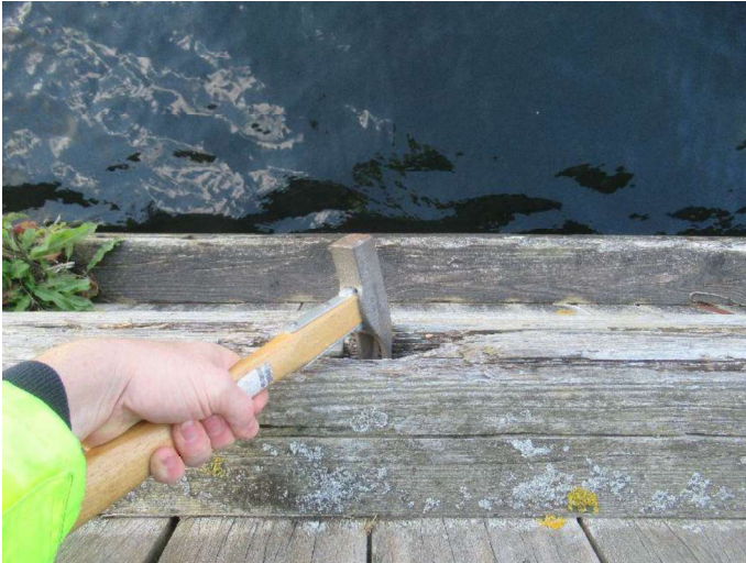
Kajstrækning øst - Fendre 1 Betydelig udvaskning af materiale i fendre.
