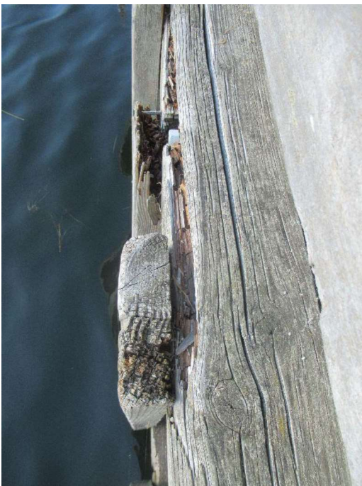
Kajstrækning øst - Fendre 2 Fendre ses flere steder med nedbrydning og i dårlig stand.
