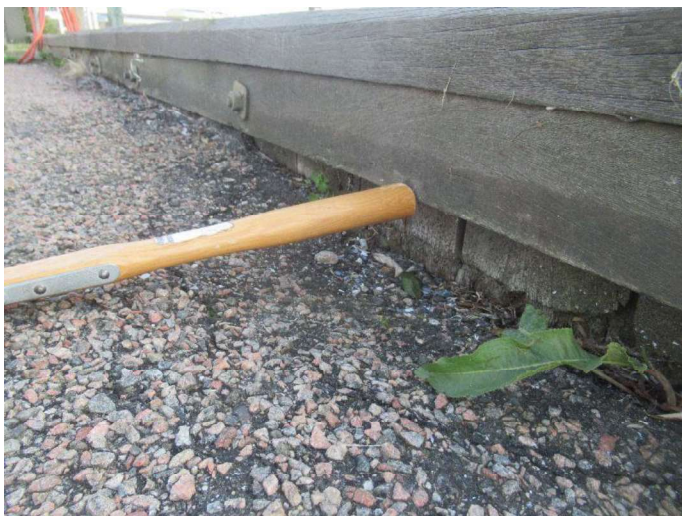
Kajstrækning nord - Kajvæg Enkelte steder ses der lunger i asfalten ovenfor kajvæggen.
