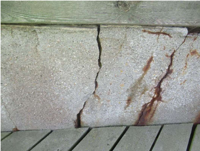
Molehoved 2. Stenkastning vest - Vægge Kraftige revner ses i betonvæggen fra vandsnit til bjælke i top.
