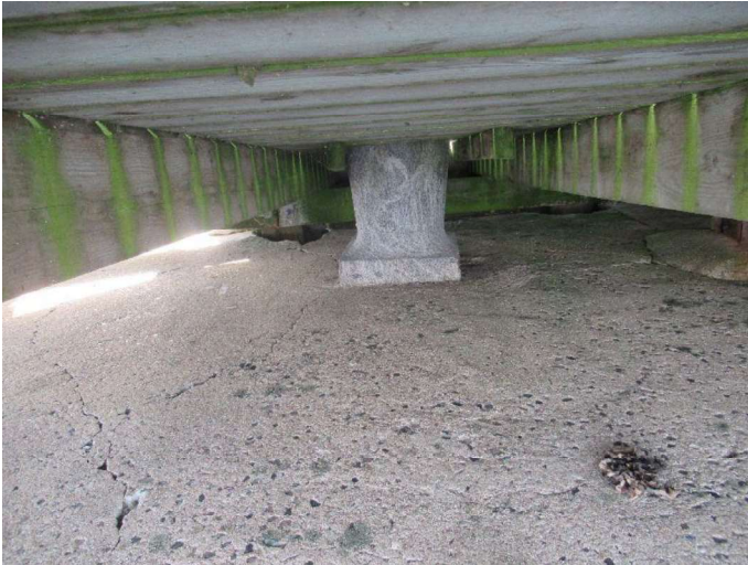
Molehoved 2. Stenmole vest - Belægning Der ses flere revner i molehovedets originale overflade.
