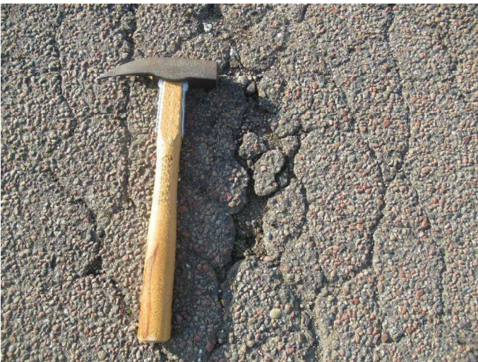
Vej- og parkeringsareal - Løs asfalt
