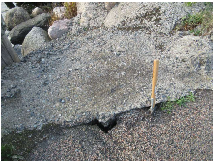
Kajstrækning nord - Kajvæg Ved den vestligste del af kajstrækning nord er der helt beton ud som fungerer som en "klods" i enden. Mellem asfalten og betonen er der hulrum hvilket kan skyldes udvaskning af materiale i havenen. Hullet bør efterfyldes og herefter noteres om materiale forsvinder derfra.
