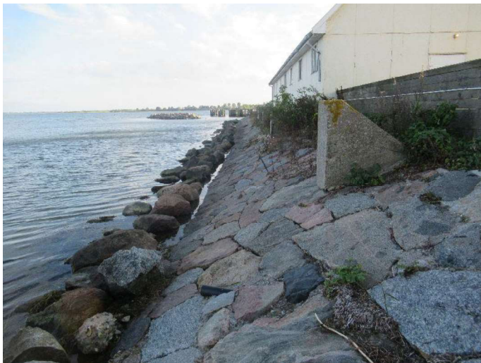
Stenkastning øst - 2 Stenkastning langs bygninger hvor mørtel flere steder har sluppet stenene.
