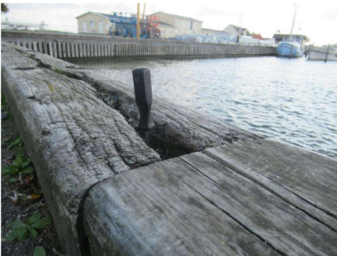
Kajstrækning øst - Hammer Hammer ses flere steder med råd og nedbrydning.
