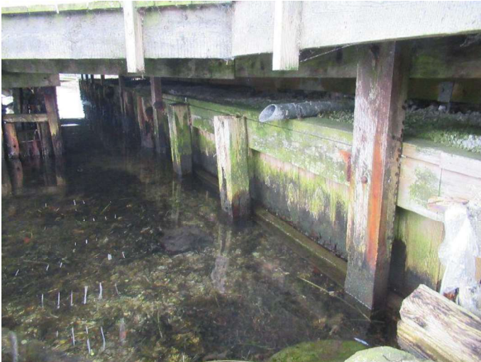
Kajstrækning nord Kajvæggen fremstår i dårlig tilstand og flere af pælene og delvist eller helt borttæret.
