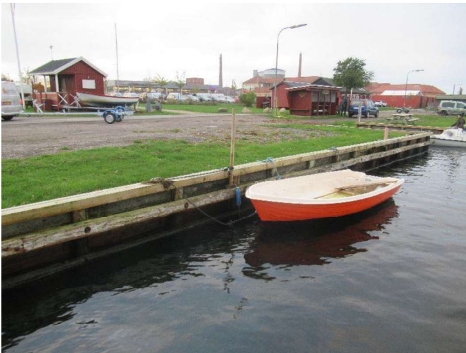
Kajstrækning Fiskerstræde - efter slæbested øst Efter slæbested øst er der både trykimprægnerede og ubehandlede pæle i kæbenhavnervæggen. De trykimprægnerede fremstår i fin stand imens du ubehandlede fremstår med nogen nedbrydning.
