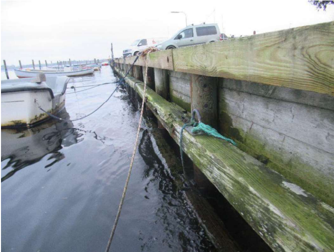
Kajstrækning Fiskerstræde - mellem slæbested vest og øst Imellem slæbested vest og øst er der nyere trykimprægnerede pæle, der fremstår i ok tilstand. Den langsgående bjælke er dog flere steder nedbrudt og flere af de øverste brædder ses stærkt nedbrudte eller manglende.
