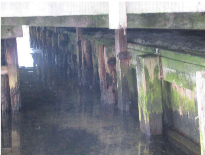
Kajstrækning nord Kajvæggen fremstår i dårlig tilstand og flere af pælene og delvist eller helt borttæret.
