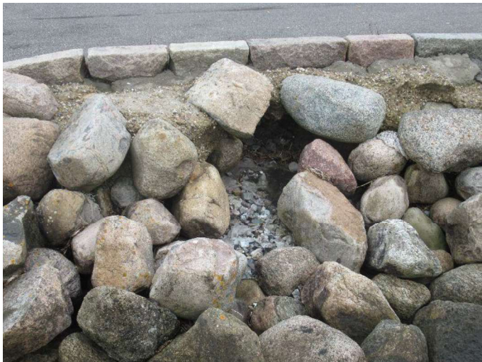
Stenkastning vest - Hul i stenkastning
