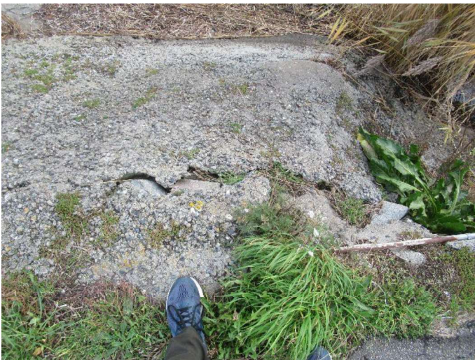
Slæbested vest - Revner i nordlig mørteludkastning I den nordlige væg/mørtelvæg ses der grove revner i toppen der nok skyldes at væggen har sat sig.
