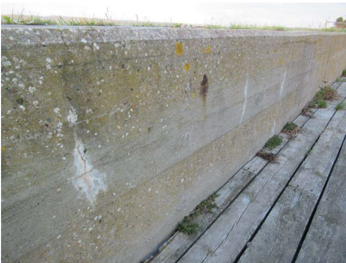
Mole - Kajvæg Mellemfine revner med hvide udfældninger
