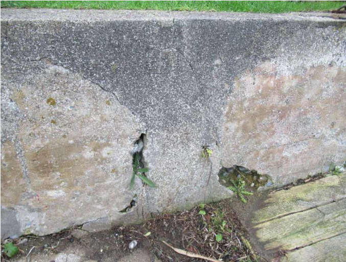
Slæbested - vægge Grove revner og huller ses flere steder i væggene.
