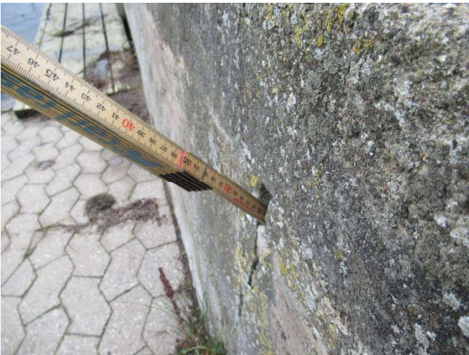
Slæbested - vægge Flere af hullerne i betonvæggen er dybe/gennemgående.
