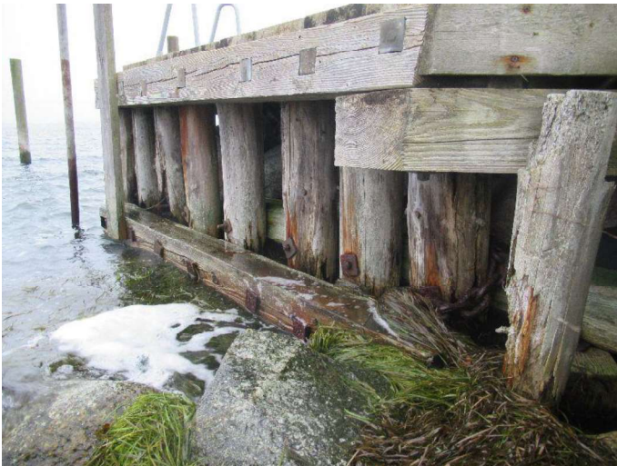
Molehoved - pæle Bjælker og fendre fremstår i ok tilstand imens pæle fremstår med kraftigt reduceret tværsnit.
