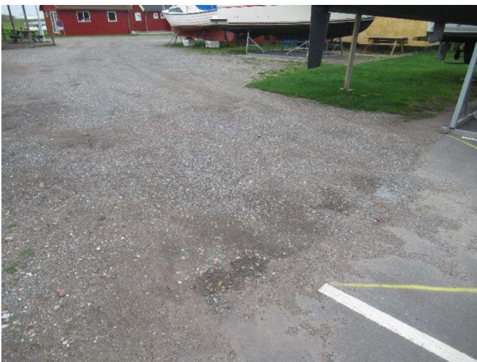
Vej- og parkeringsarealer - Oversigtsbillede Nogle lunger ses i overgangen imellem belægning.
