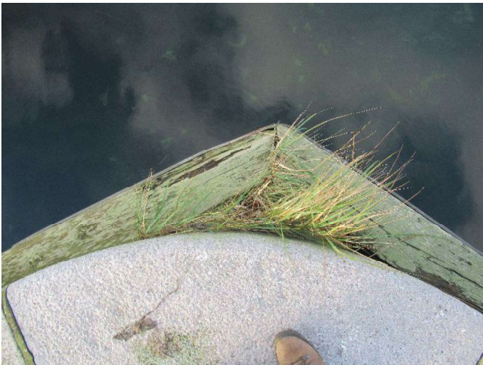
Kajstrækning syd - Kajvæg I kanten imellem den øverste bjælke og granithammeren ses flere steder uønsket bevoksning.
