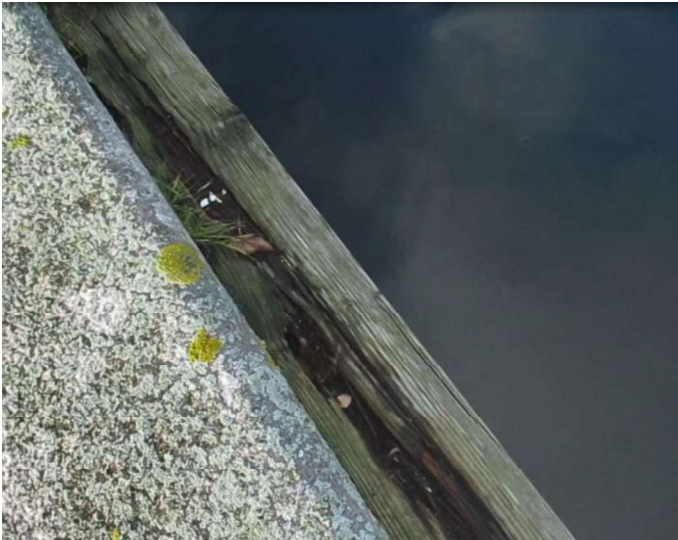
Kajstrækning syd - Kajvæg Kan væggen fremstår slidt og er flækket flere steder.
