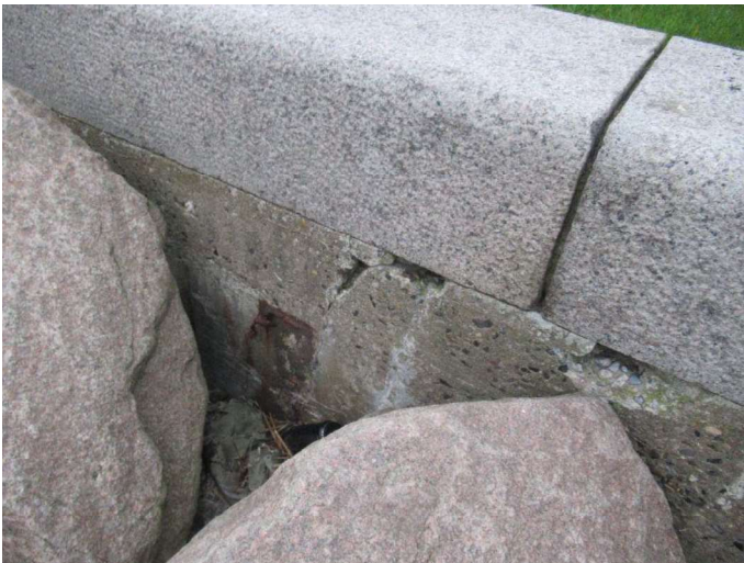
Skråning 2 - Skader i betonvæg
