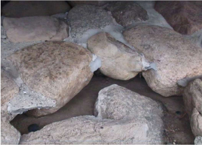
Skråning 3 - Underskyldninger ced bro 5
