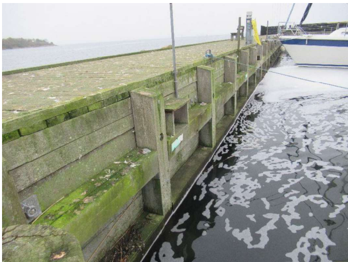
Bro 1 - Kajvæg - Københavnevæg Væg og brodæk fremstår især yderst strækt misfarvede.
