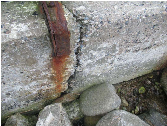
Bro 1 - Kajvæg - Betonvæg Der ses flere gennemgående lodrette revner i betonvæggen. Der er dog ikke tegn på sætninger eller udskyldning af bagvedliggende materiale (i hvert fald ikke hvor visuel registrering var mulig).
