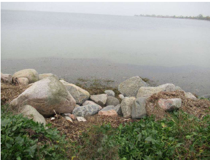
Stenkastning nord - Skred og huller
