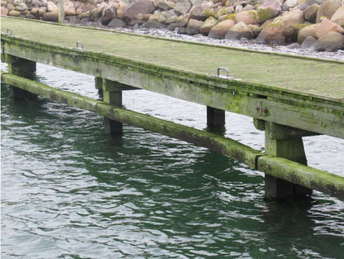
Bro A - Fendre Knækket fender ud for plads A3.
