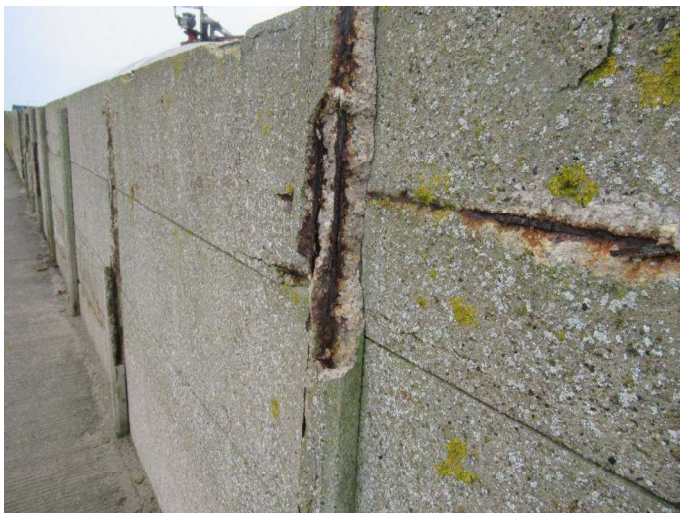
Yderhavn sydøst - Læskærm I flere af læskærmens stolper ses der kraftig korrosion i armeringen, der er blotlagt grundet manglende dæklag.
