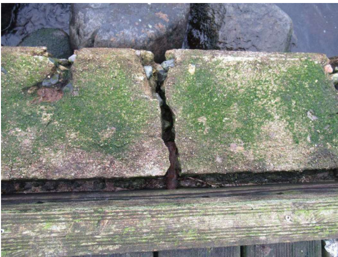
Bro A - Betonoverbygning Grove gennemgående revner ses flere steder i betonvæggen.
