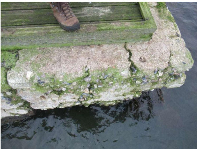
Bro A - Betonoverbygning Yderste på platformen ses der kraftig underminering/afskaldninger af betonkonstruktionen.
