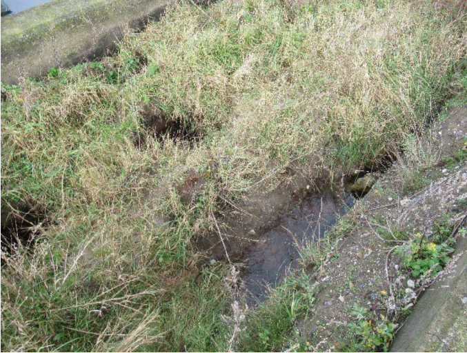
Kaj øst - Kajvæg Materialet bag væggen er stort set helt skyllet væk.
