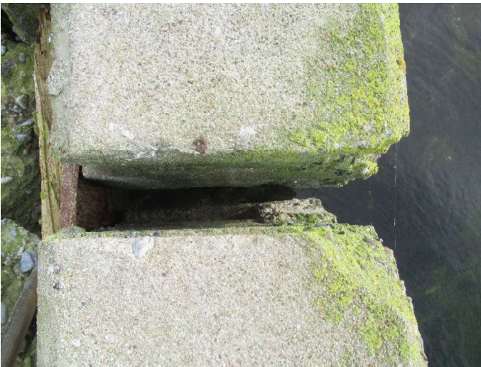
Kaj øst - kajvæg Yderst ses to store gennemgående revner i væggen.
