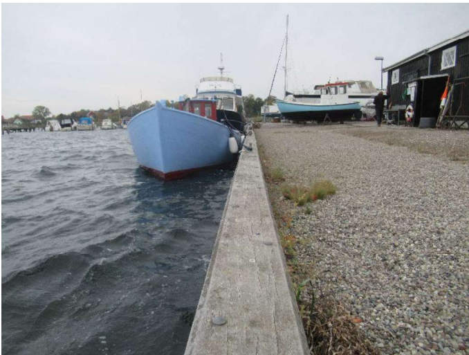
Kajstrækning vest - Hammer Træhammeren har sat sig en smule på midten som følge af sætninger i væggen.
