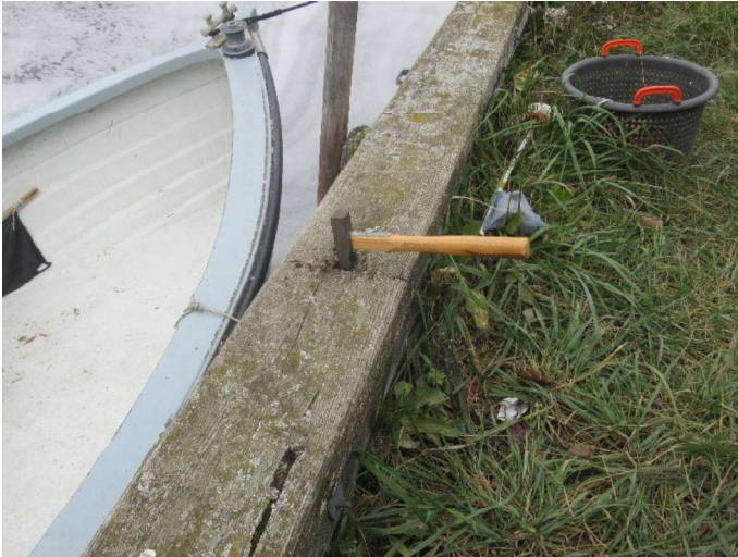
Kajstrækning vest - Hammer Flere steder viser hammeren tegn på nedbrydning.
